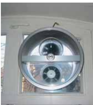
Abb. 3: Der lokale Lüfter „Ökolüfter“ ins Fenster eingebaut Foto: IBN Institut für Bauen und Nachhaltigkeit
