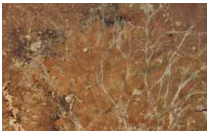
Abb. 14: Doppelbefall: Feine, eisblumenähnlich verzweigte, weiße Stränge des Stachelsporlings ( Treichispora sp.) auf dem ockerfarbenen Mycel des Ausgebreiteten Hausporlings ( Donkioporia expansa ).
