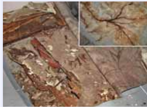
Abb. 5: Reste eines Kellerbodens; aufsteigende Feuchte zusammen mit dem PVC-Belag haben an der Unterkonstruktion zu Durchfeuchtungen und nachfolgend zu massiven Kellerschwammsschäden geführt; das Eckbild zeigt Details des Mycels.
