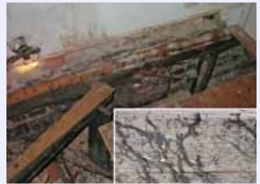
Abb. 6: Reste einer Küche; unzureichende Wartungsfugen-Pflege hat am innenliegenden Streichbalken zu Durchfeuchtungen und nachfolgend zu massiven Kellerschwammsschäden geführt; das Eckbild zeigt Details des Mycels.
