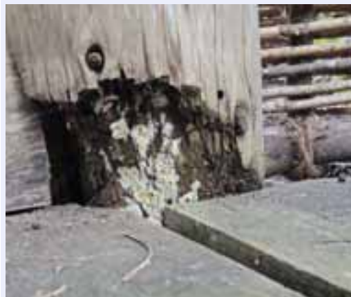
Abb. 9: Braunfäuleschaden: Reste eines Haus-Eckpfilers. Aufgrund eines direkten Erdbodenkontaktes kam es bereichsweise zu einem massiven Kellerschwamm-Schaden.
